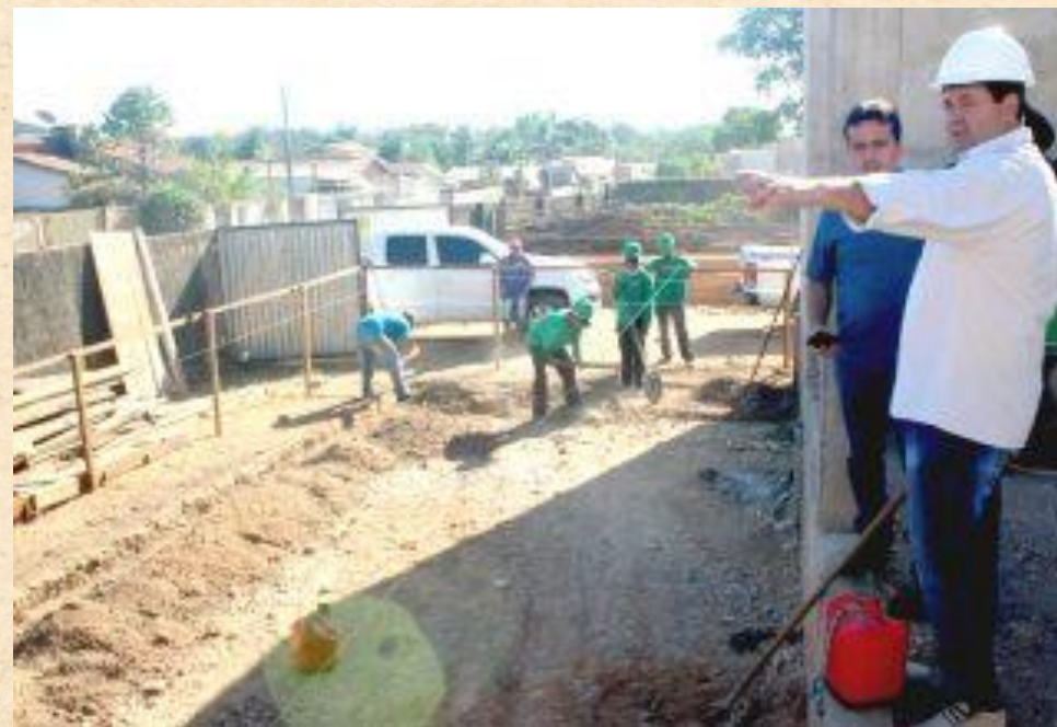
Fundação fora do padrão estabelecido
