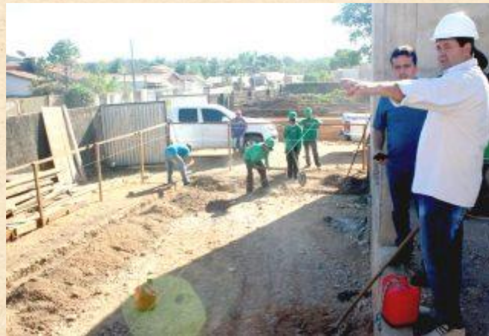
Fundação fora do padrão estabelecido
